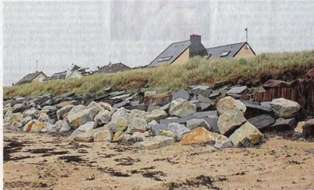
Quatre maisons sont particulièrement menacées par la violence des tempêtes et les grandes marées.
