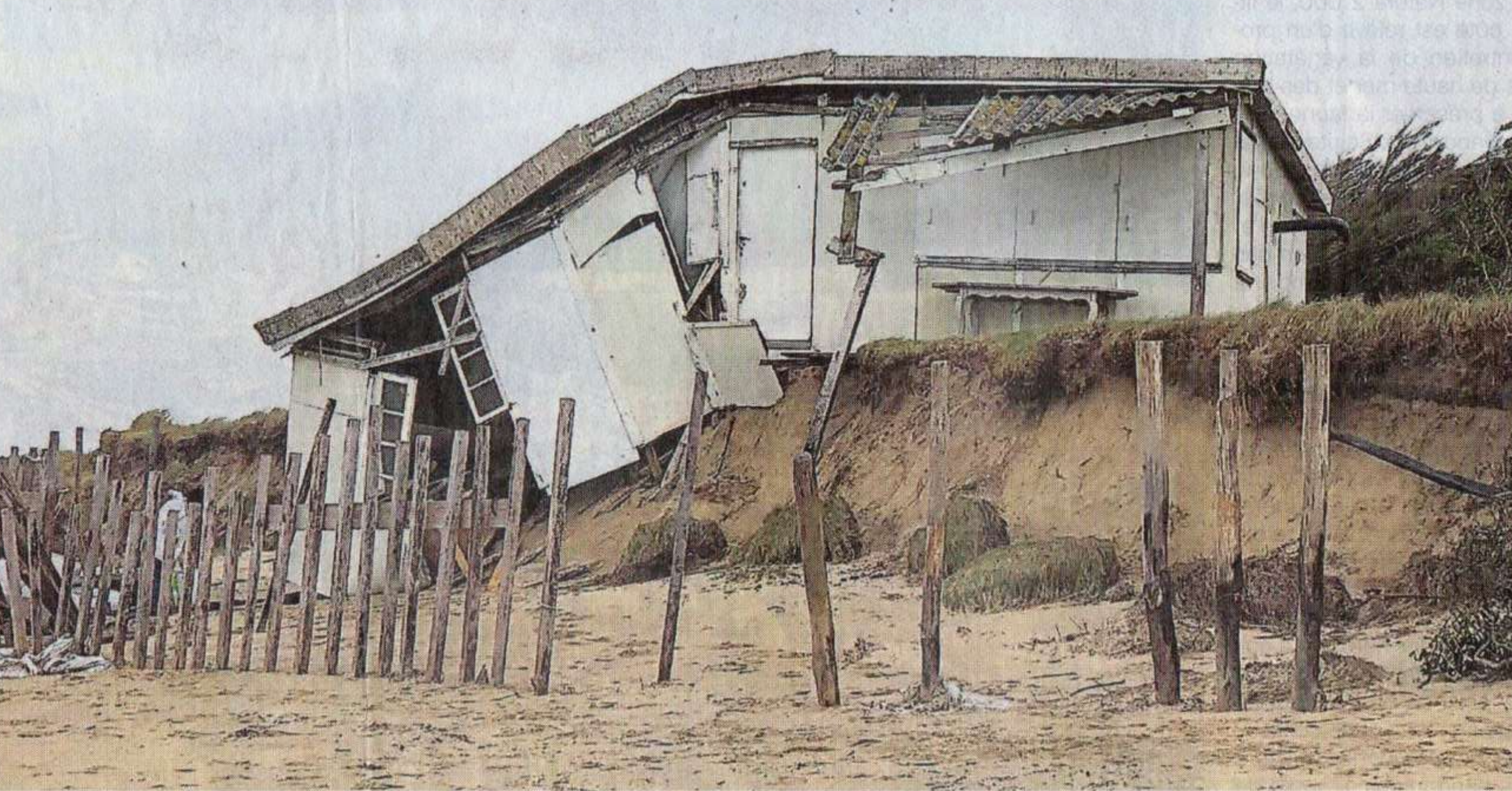
Blainville-sur-Mer, l'érosion attaque la dune et la cabane située dessus s'effondre.
